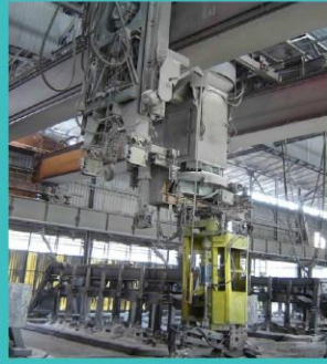
POGLED NA MOSTNU DIZALICU U KAP-u
