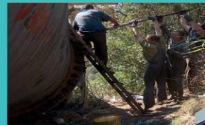
PROBLEMATIČNA DEMONTAŽA ZBOG LOŠE PROJEKTOVANOG RIJEŠENJA DILATACIJE T8
